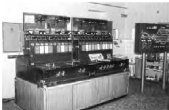
Hulín, řídicí přístroj 1 v dopravní kanceláři v roce 2000.
