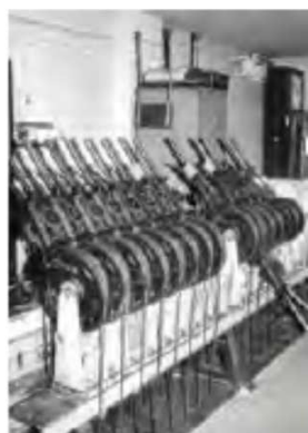
Bohumín, elektromechanický stávkový přístroj ve stávkově 1, dnes smeseno, stav v roce 1999.
