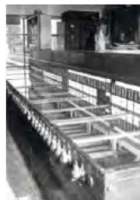
Přerov, elektrodynamické zabezpečovací zařízení ve stávkově 2, stav v roce 1999.
